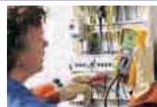
Проверка изоляции в распределительном щите
